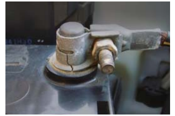
亀裂が入ったターミナル
